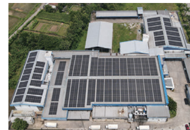
出資後に設置したPT Kanemory Food Service 本社の太陽光パネル
